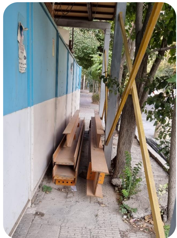
• پیاده‌رو توسط تیرهای فلزی اشغال شده
